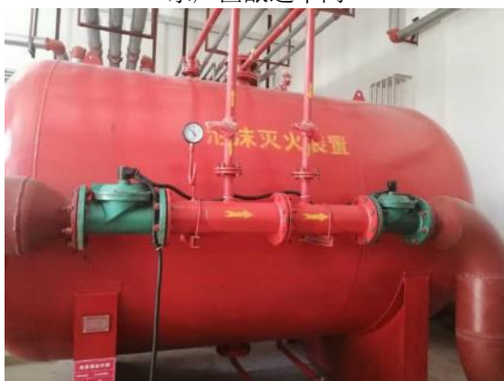
东厂区泡沫灭火装置
