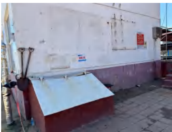
消防砂池（现有工程）
