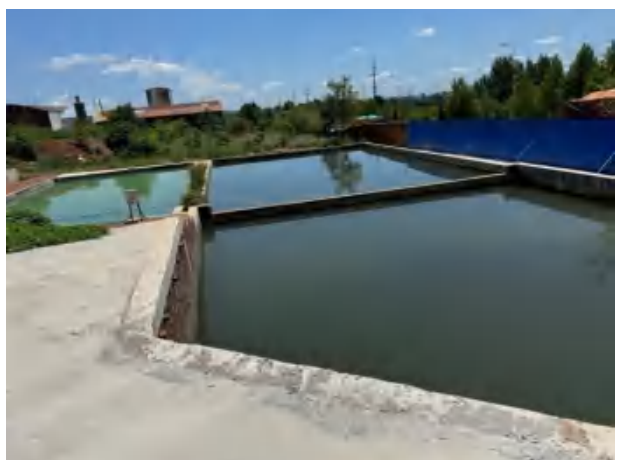
污水处理站回水池、初期雨水收集池（现有工程）
