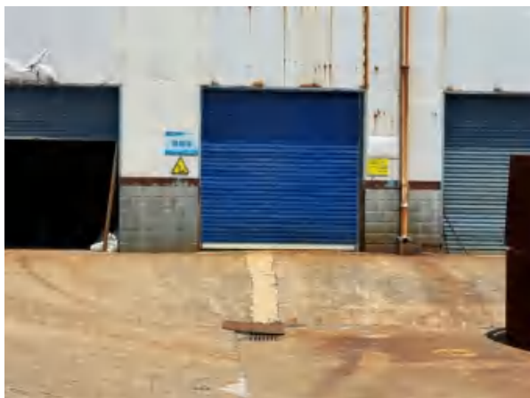
危险废物暂存间（现有工程）
