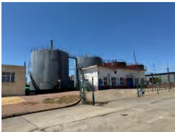
硫酸储罐（现有工程）
