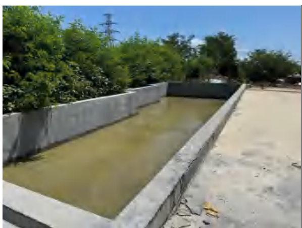
冷却水循环水池
