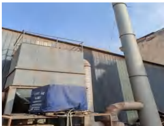
已建除尘器及排气筒（DA001）
