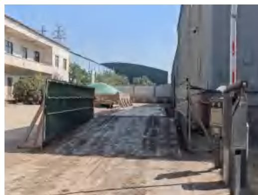
门禁及车辆冲洗装置（现有）
