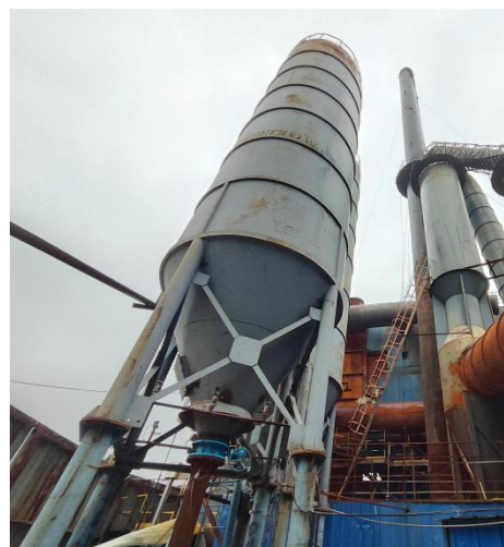
现有工程-脱硝设备
