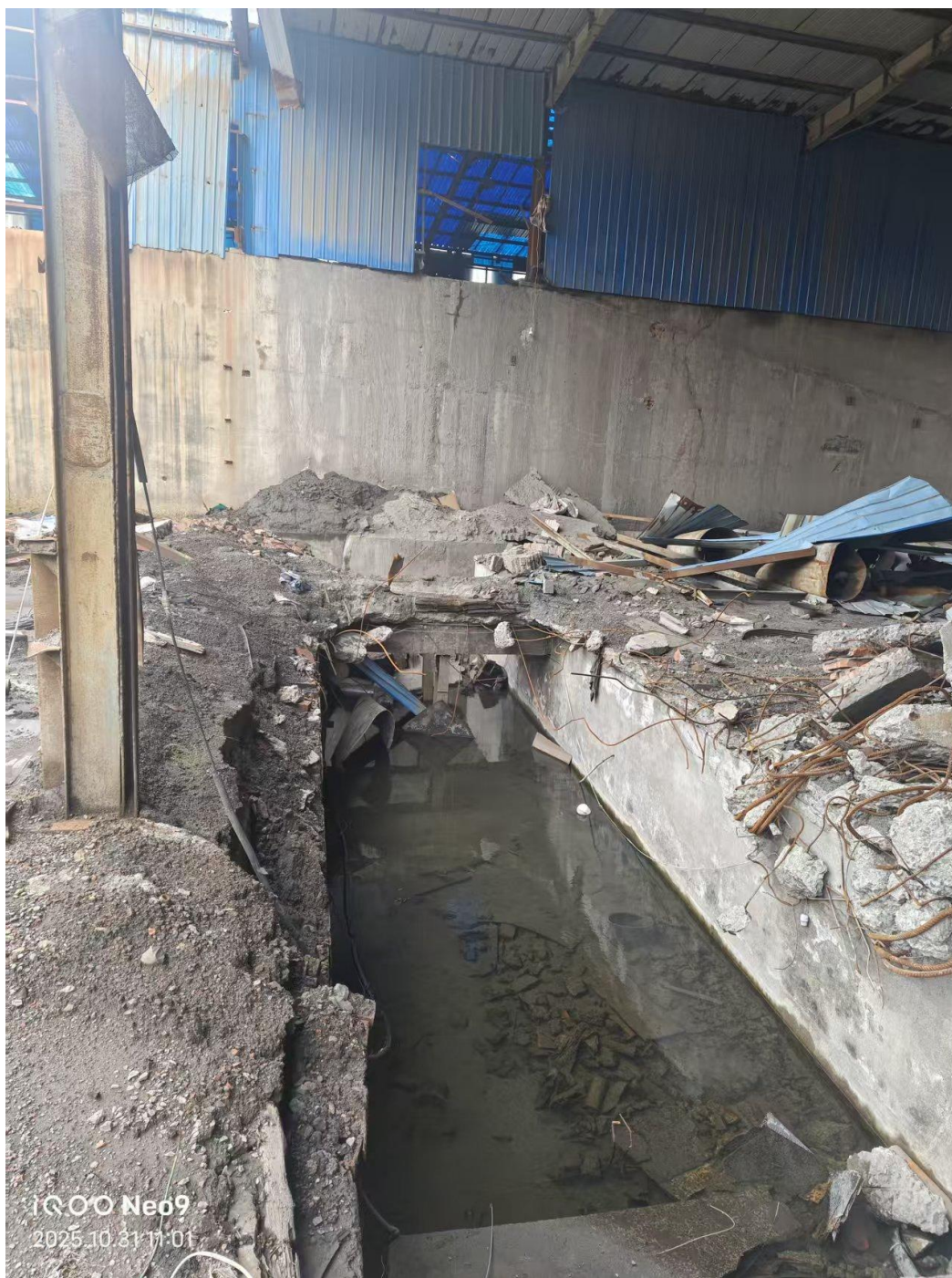
圆锥破碎，锤式破碎已拆除
